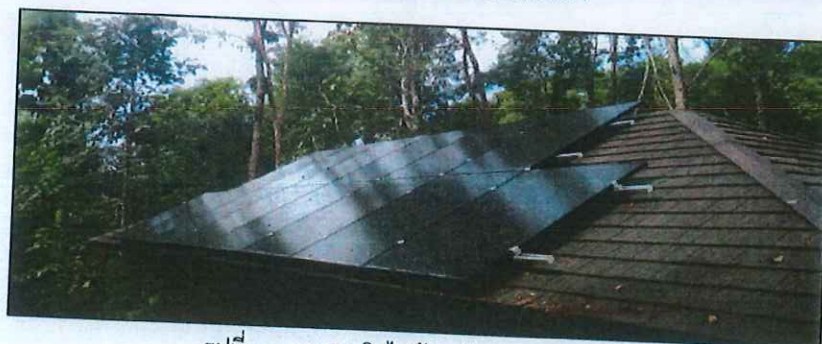
รูปที่ ๑๓ ระบบผลิตไฟฟ้าพลังงานแสงอาทิตย์
