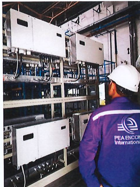
ตัวอย่างภาพห้อง INVERTER ROOM
