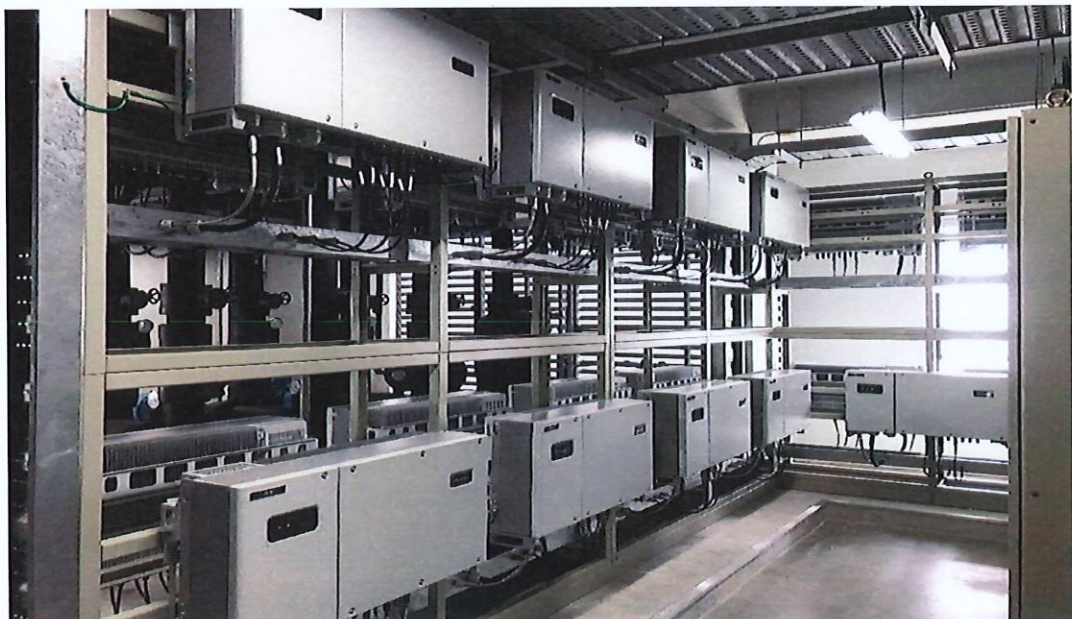
ตัวอย่างภาพห้อง INVERTER ROOM
